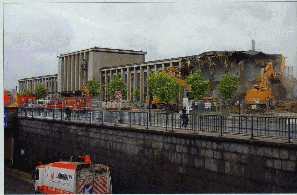
↓ FOTO 116-99 In mei en juni werd het station van Mons gesloopt. De foto toont de toestand op 14 juni. Pierre HERBIET.
