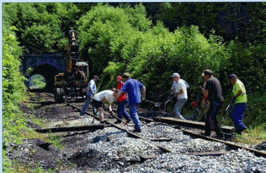
De dwarsliggers tussen de tunnels van Lèche (op de achtergrond) en van Purnode werden vervangen op 7 juni. TSP.
